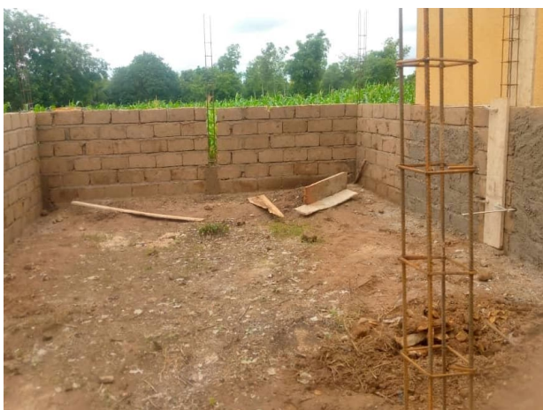
De buitenmuren staan overeind
